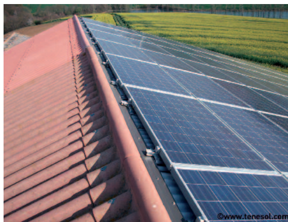
Ce bâtiment agricole équipé d'une toiture photovoltaïque avec la solution intégrée SIT-M est située à BEAUMONT SUR LEZE (31). Les 436 modules Tenesol qui recouvrent les 750 m 2 de toiture ont une puissance installée de plus de 100 kWc.
